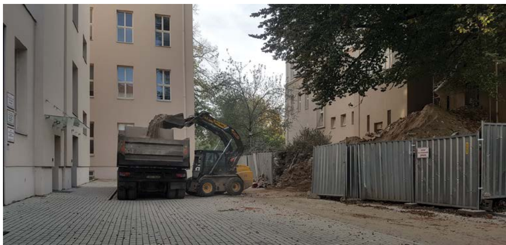
Stavební práce na rekonstrukci budovy č. 31 se uskutečňují v těsném sousedství budovy č. 32, která je v plném provozu
