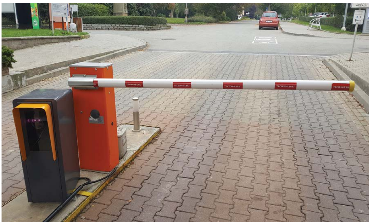
Univerzita modernizovala systém vjezdu a výjezdu do areálu na úroveň rozpoznávání státních poznávacích značek automobilů
