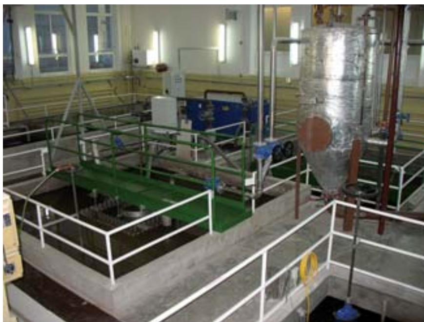
■ Vnitřek čistírny prošel generální rekonstrukcí
