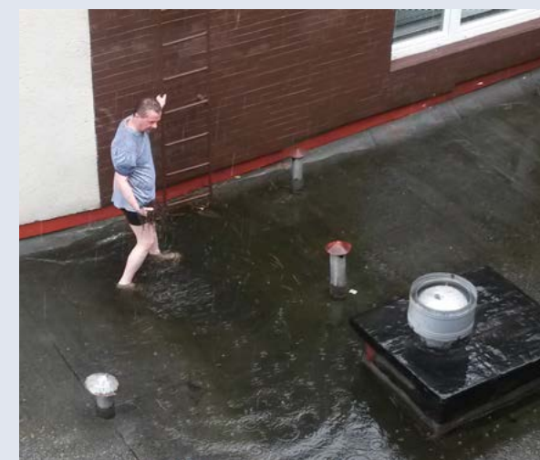
Bylo potřeba rychle vyčistit odtokové výpustě
