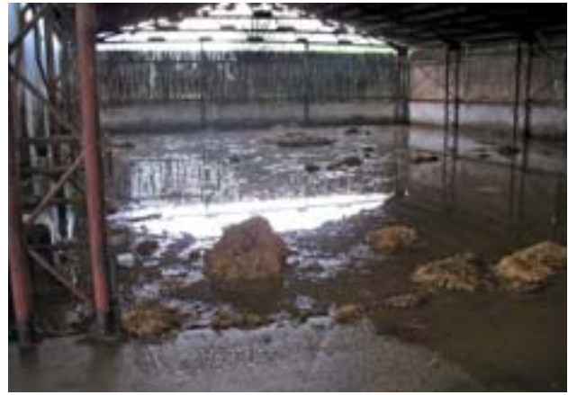
■ Poškozené zařízení ŠZP
